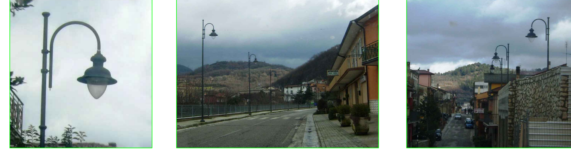
illuminazione viabilità principale con armature tipo ornamentali a sospensione Lampade ai vapori di sodio (SAP)
